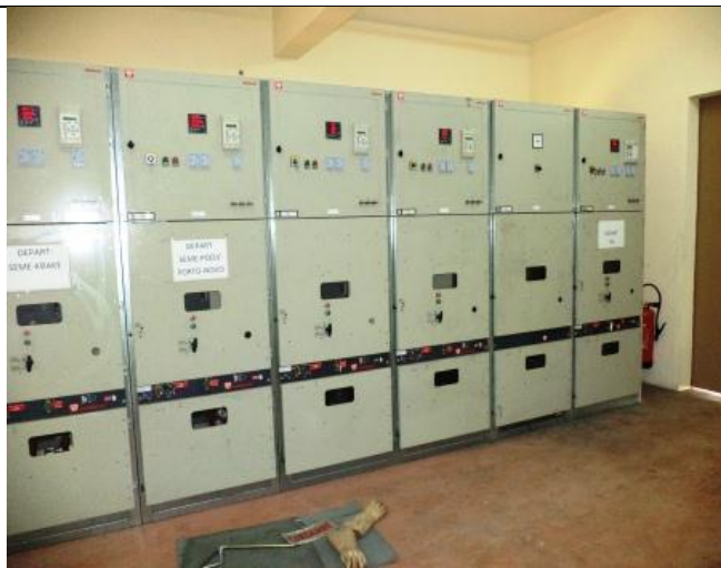
Equipement_Mesure_et de contrôle site SEME
